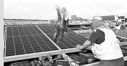
德国勃兰登堡州,工人们正在安装太阳能电池板(2024年8月29日摄)。图片来源:视觉中国
