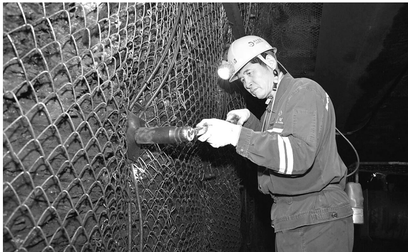
5月9日,张建红在工作面确认帮锚杆预紧力。河北日报记者 赵永辉 摄
